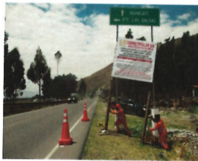
Foto N° 1: Panel instalado en el Cruce de la Huaycha
